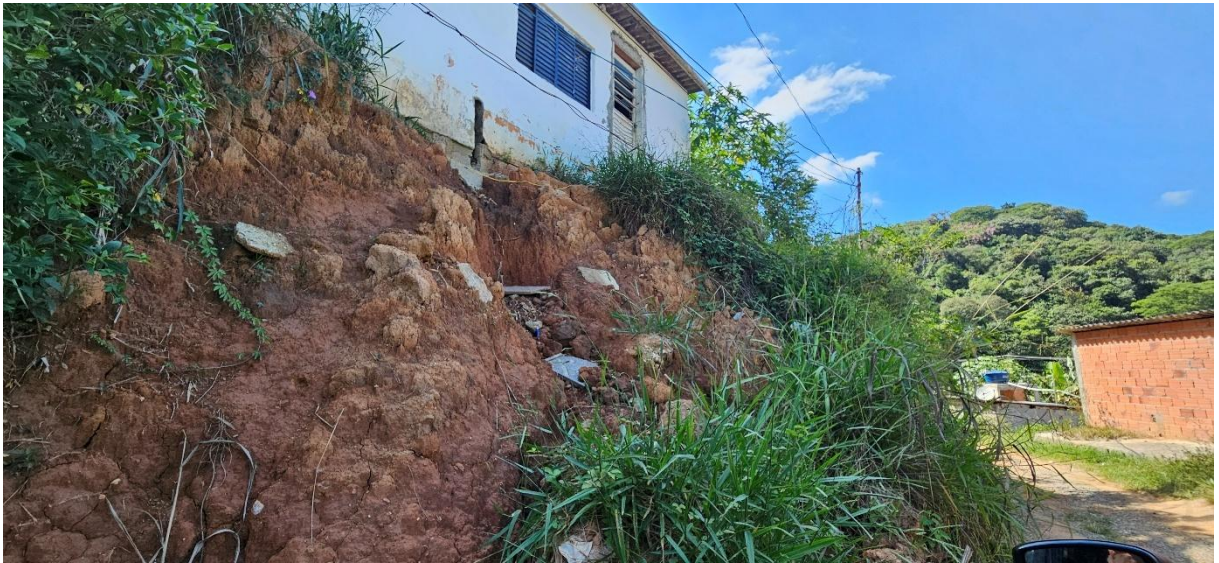
Figura 65: Moradia em área de alto risco – Rua Eugênia Soares da Silva Fotografia: Felco Faleiros, mar./2025
