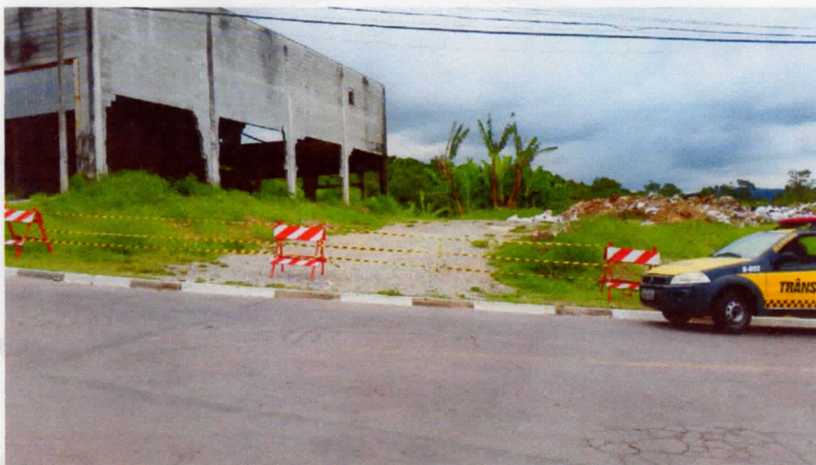
Imagem 02: Interdição da área e remoção dos resíduos.
